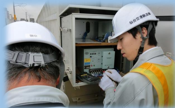
通信設備の点検
